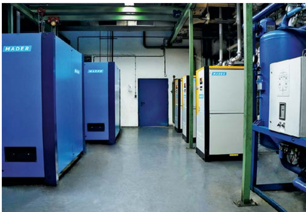
Blick in einen der beiden Kompressorräume bei Cooper in Lindau. Hier stehen insgesamt vier 250 kW Kompressoren, die das gesamte Werk mit Druckluft versorgen.
