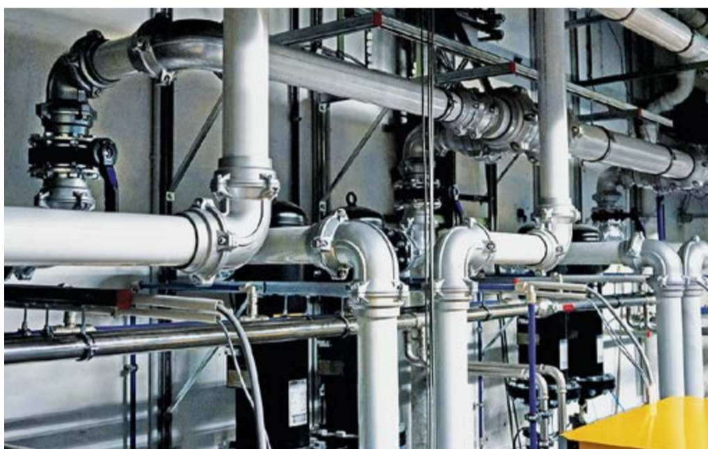
Rund 100 Meter Rohrleitungen aus Stahl wurden durch Alu-Rohrleitungen mit bis zu 168 Millimeter Durchmesser ersetzt.
