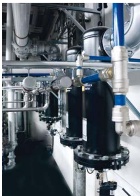
Druckluft-, Kondensat- und Kühlwasserleitungen wohin das Auge blickt!
