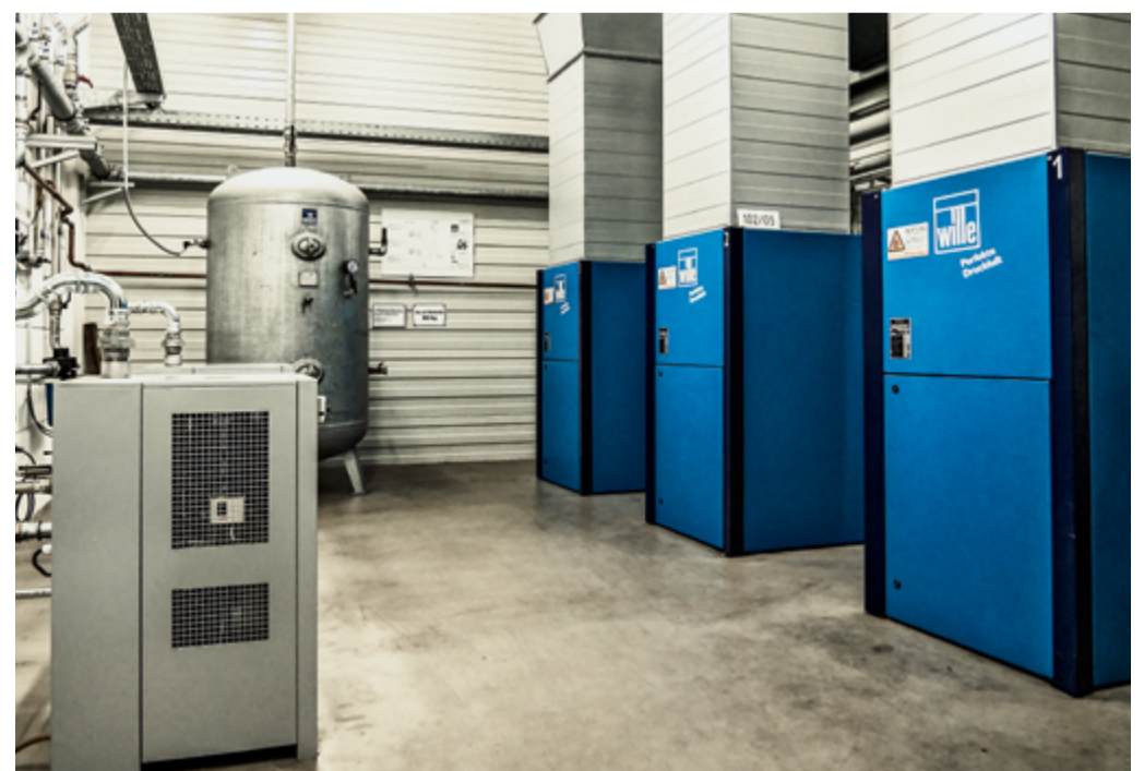
Moderne Kompressorenanlagen, wirkungsvolle Aufbereitung und ein durchdachtes Rohrleitungssystem sind Grundbausteine für eine zuverlässige Druckluftherzeugung.
